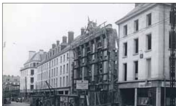
Un chantier particulier, en 1950, rue des Trois Cailloux, la façade de l'ancien théâtre est « reculée » pour s'adapter au nouvel alignement des bâtiments.
